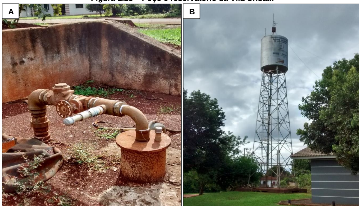
Figura 1.23 – Poço e reservatório da Vila Cristal.
