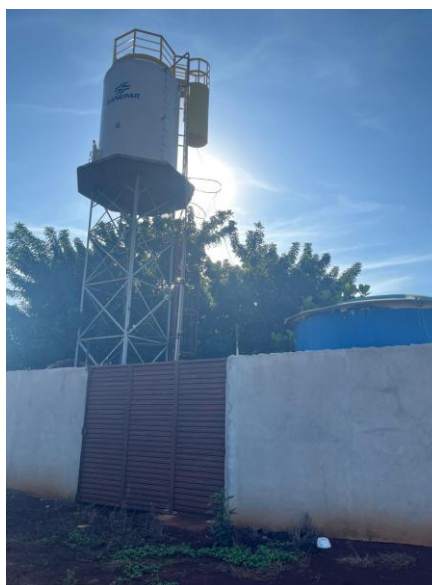
Figura 28 – Poço de captação e reservatório (Planalto do Oeste)
