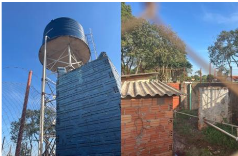
Figura 27 – Poço de captação e reservatório (Planalto do Oeste)
