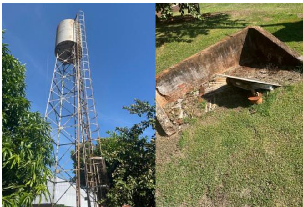
Figura 29 – Poço de captação e reservatório (Vila Cristal)
